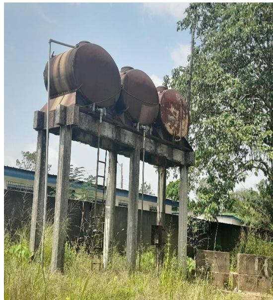
Photo 4 : Un forage d'eau non fonctionnel.
